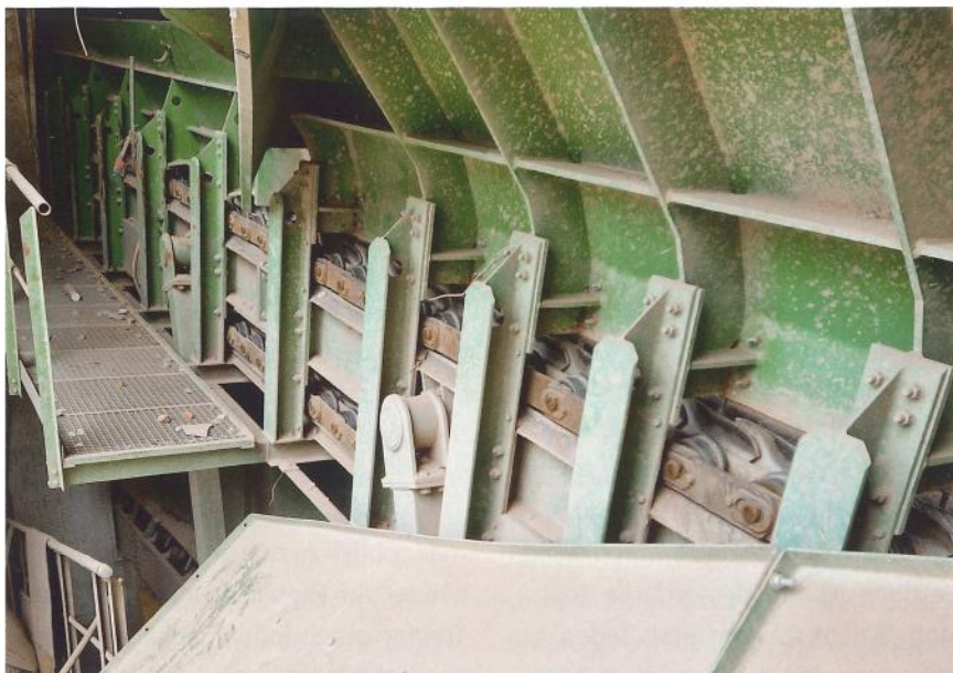
Seitenansicht der Förderanlage
