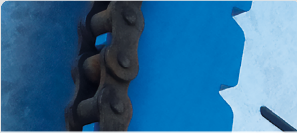
Unbeschichtete Kette ist durch Einwirkung verschiedener Umwelteinflüsse (z.B. Regen, Streusalz, salzhaltige Luft in Häfen) stark verrostet.
